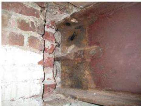
Locatie profiel : C; Etage 3 Fotonummer :291 Bevinding : Corrosie/ delaminatie
