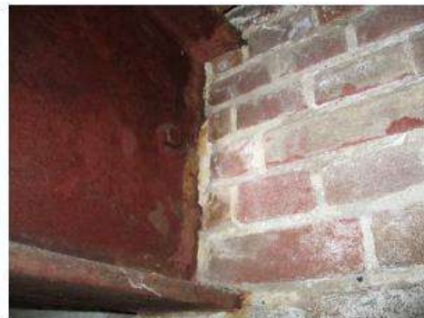
Locatie profiel : C; Etage 3 Fotonummer :292 Bevinding : Corrosie/ delaminatie
